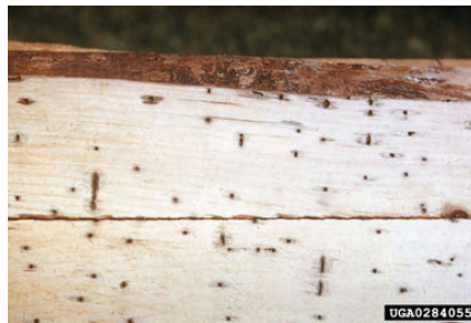
Fig. 83. Daño causado por platipódidos
